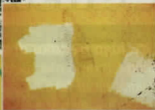
Sekolah terpaksa mengeluarkan belanja besar untuk membeli cat bagi memadamkan perkataan tidak baik yang diconteng pada dinding sekolah.
